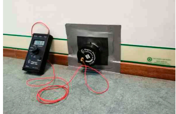
Eristetty mittausväline, asennettuna LLL-järjestelmään
